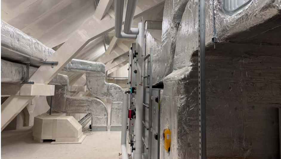
Neue Lüftungsanlage im Dachboden: Das Dachgebälk ist unter einer Verschalung verschwunden.
